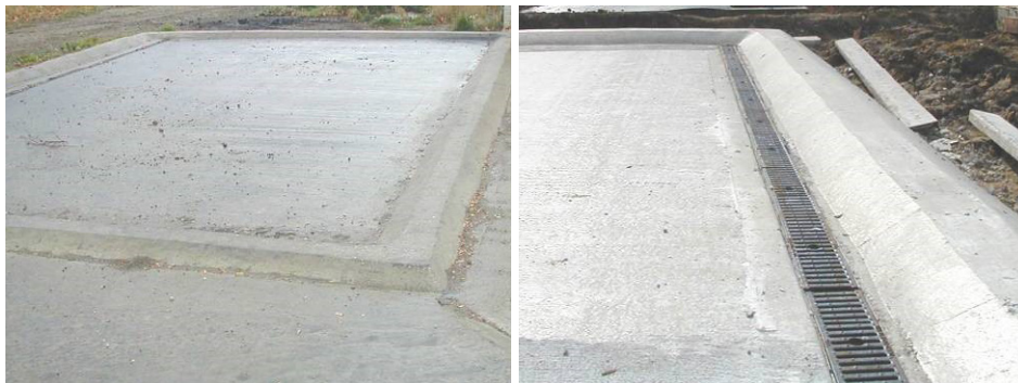
Obr. 16 a 17: Oddělené betonové plnicí a čistící místo, které odvádí kontaminované kapaliny do biočistícího systému betonovou stružkou (vlevo) nebo kanálkem s mřížkou (vpravo) (zdroj: ADAS).
