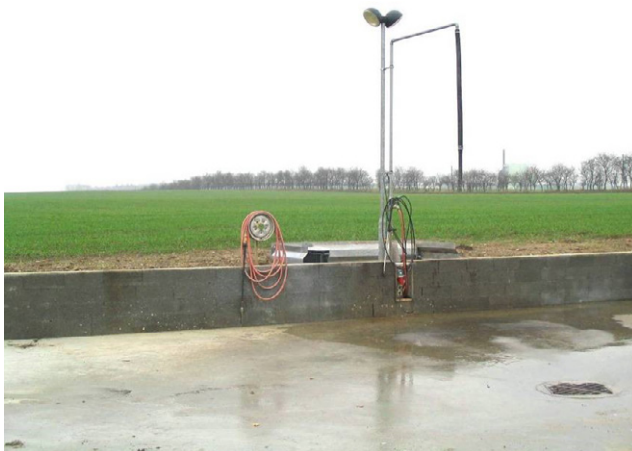
Obr. 15: Oddělené betonové plnicí a čistící místo s plnicím a čistícím zařízením, které odvádí kontaminované kapaliny do biočistícího systému (zdroj: DAAS).
